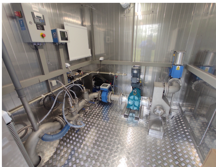
Instalacja sondy Memosens Wave CAS80E wraz z innymi urządzeniami w stacji zlewnej.
