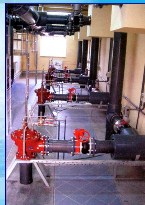
Stacja Uzdatnia Wody „Wapiennica” Bielsko-Biała zawór serii 427 DN 250
