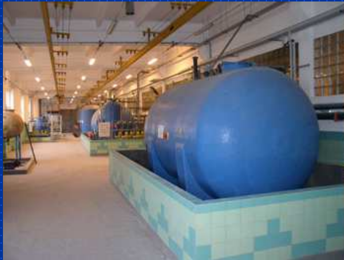
Widok ogólny stacji przygotowania i dozowania chemikaliów
