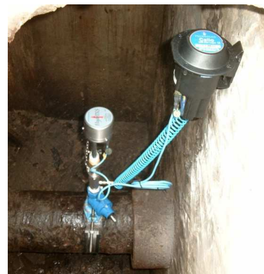
Pomiar dwukierunkowego przepływu i ciśnienia
