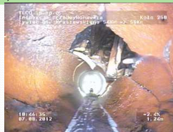
Uszkodzenie kanalizacji – brakujący fragment rury
