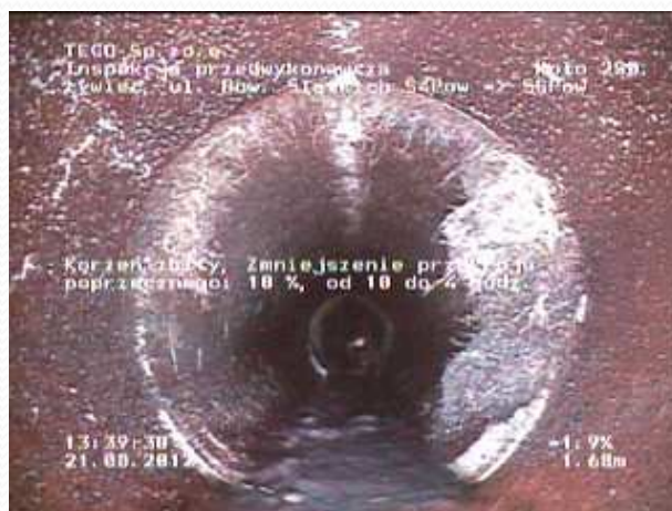
Uszkodzenie kanalizacji – zbity korzeń
