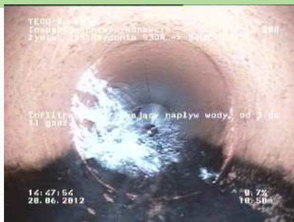
Uszkodzenie kanalizacji - infiltracja
