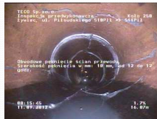
Uszkodzenie kanalizacji – spękany kanał
