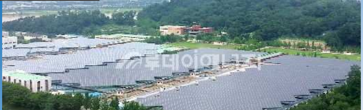
5 MW – Amsa PV Power Plant, Seoul, Korea Południowa, 2013
